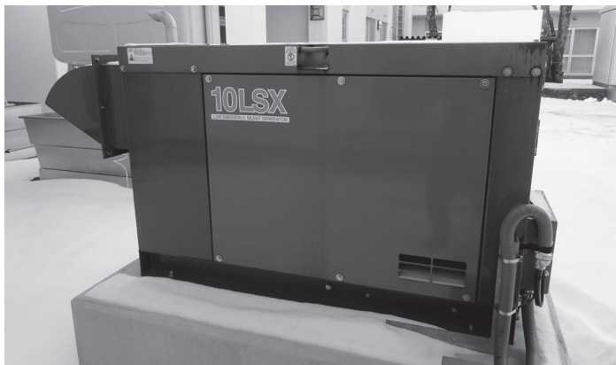
▲大活躍した発電機
