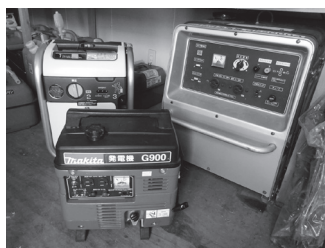
▲（左奥から）ガスパワー・小型発電機・大型発電機を使用
