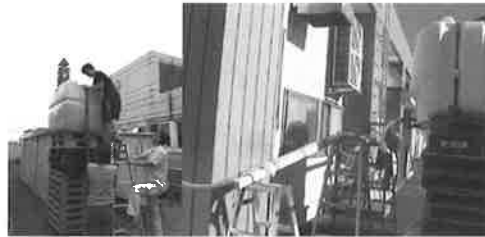
▲1tの貯水タンクを2台購入し、 厨房へ繋げて調理用の水を確保
